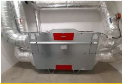
Centrale de ventilation © RBBD
