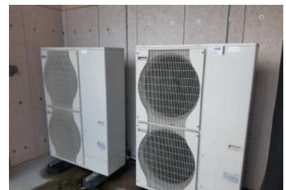
Pompes à chaleur © RBBD
